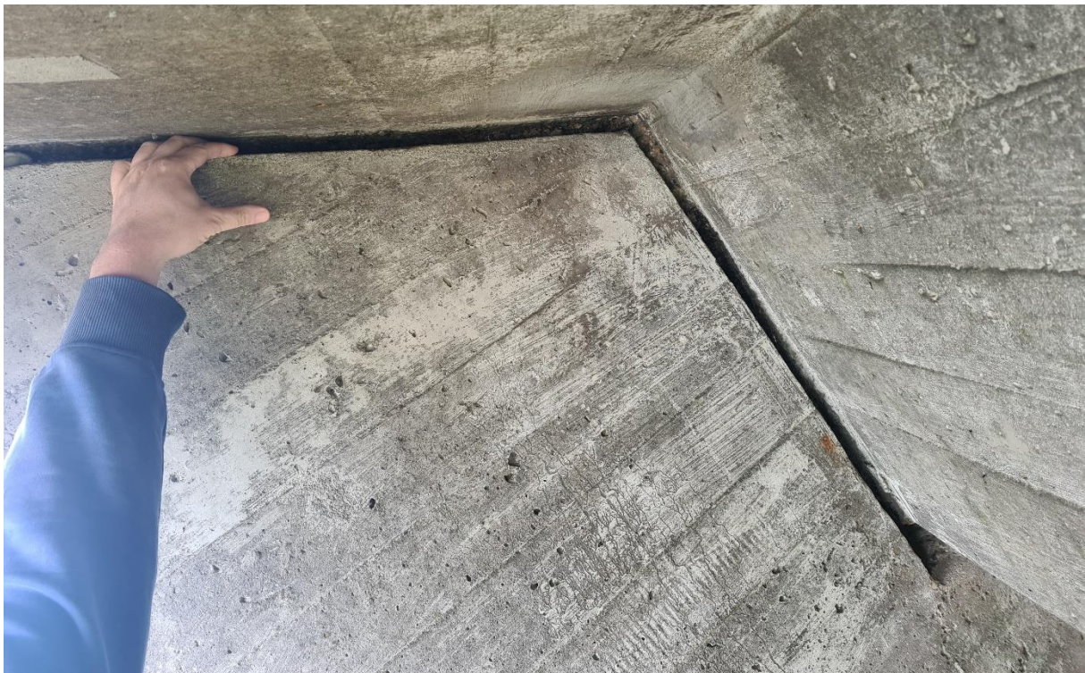
Abbildung 5: Weiterer Spalt am westlichen Bauwerk, der aufgrund seiner Struktur als Quartier für Fledermäuse geeignet erscheint (April 2022).
