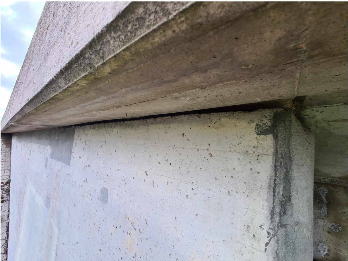
Abbildung 7: Weitere Struktur (horizontal) an der Südseite des westlichen Bauwerks, die für Fledermäuse als Spaltenquartier geeignet erscheint (April 2022).
