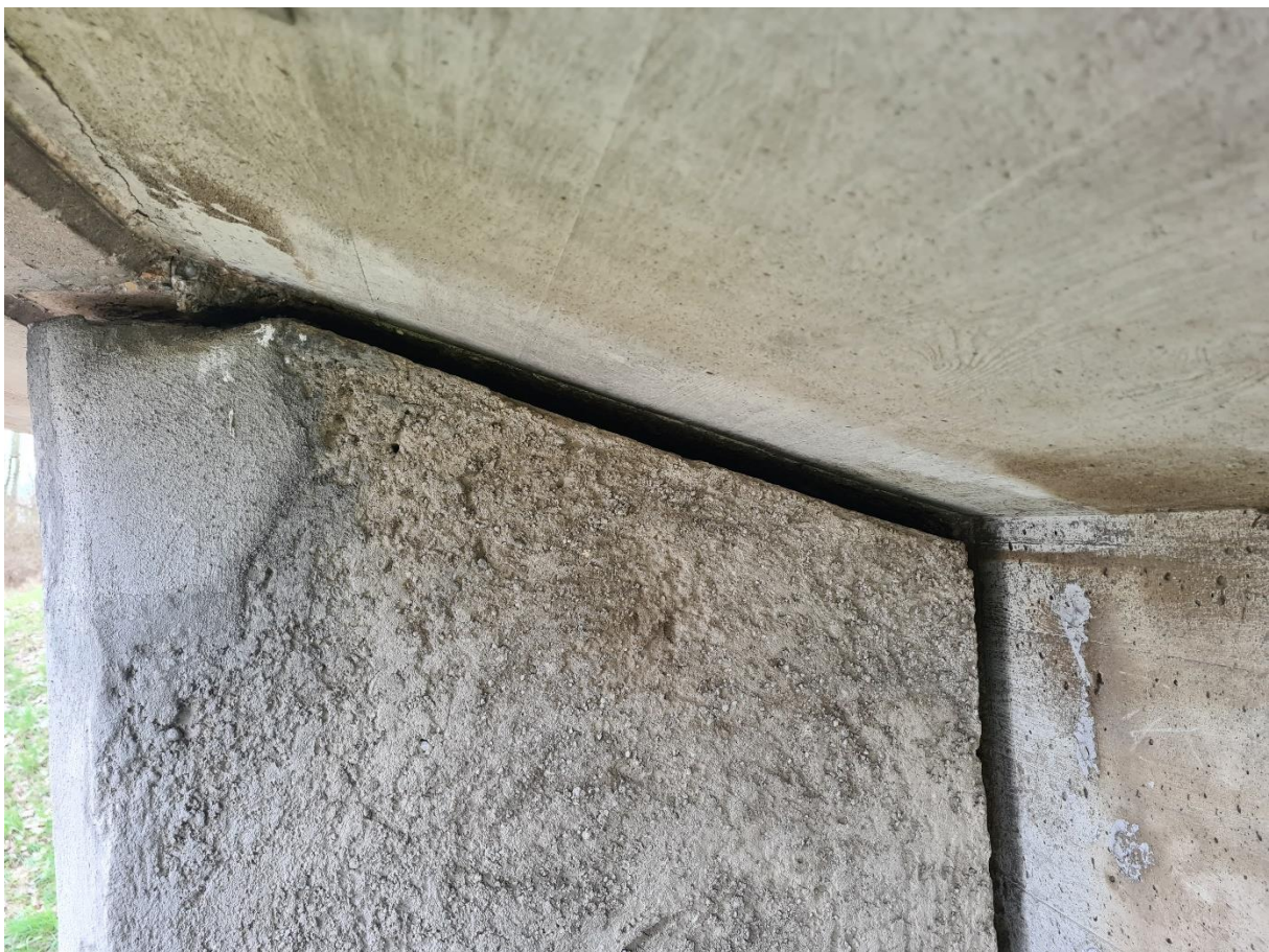
Abbildung 8: Spalt am östlichen Bauwerk, der als Fledermausquartier in Frage kommt (April 2022).
